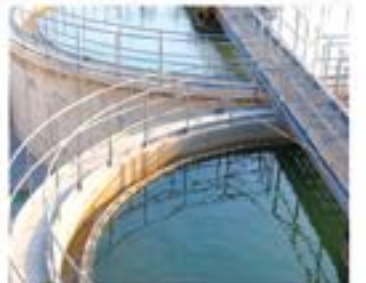
Su / Atık su
